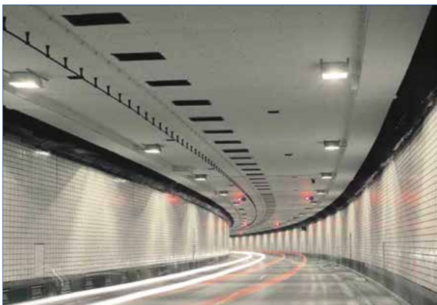
Završen projekat tunela, gde je korišćen SureHit za pričvršćivanje protivpožarnih zaštitnih ploča i radio kablova.
